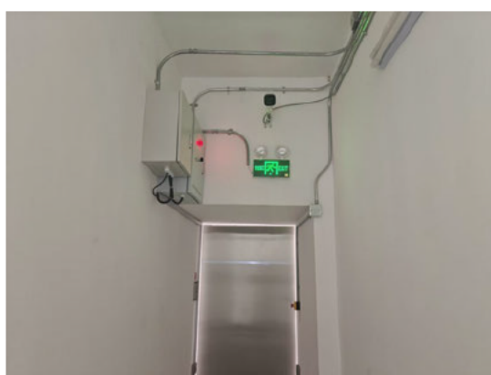
图 3-5 小加速器测试间应急出口与应急照明
