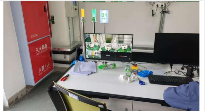
11MeV 质子加速器机房控制台
