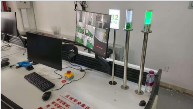
20MeV 质子加速器机房控制台
