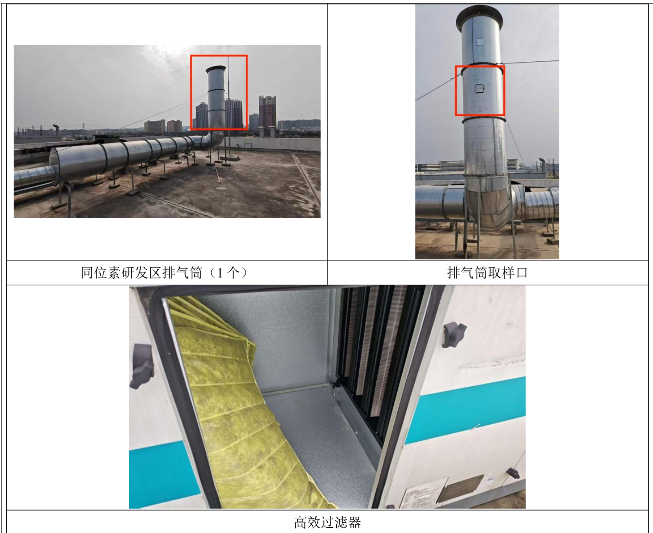
图 3-14 废气处理措施照片
